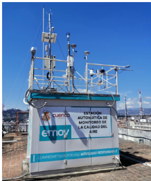
Figura 2 Estación automática de calidad del aire y meteorología localizada en la estación MUN
